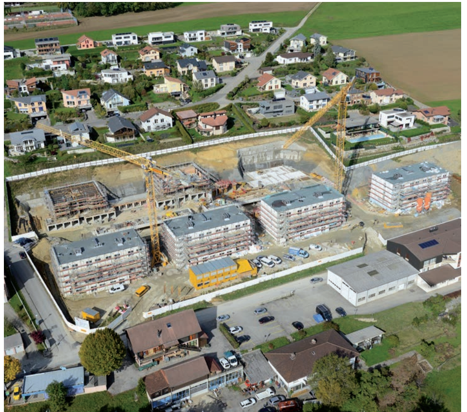
Les Héliotropes à Cernier (les quatre bâtiments en construction au premier plan)
